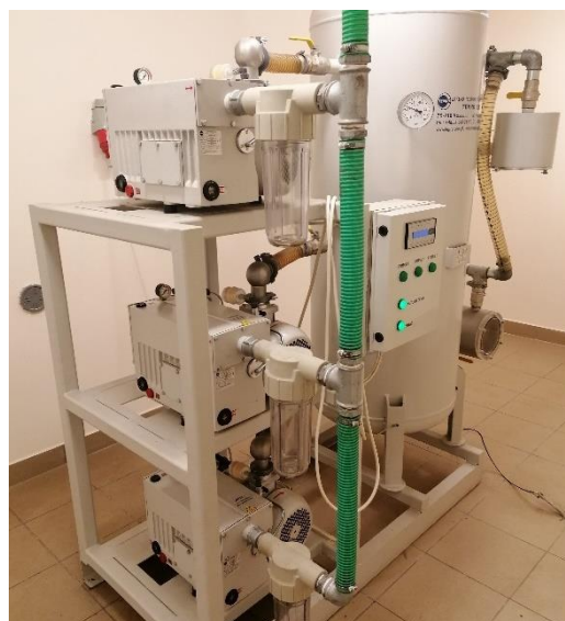
Zdjęcie 5 Bateria pomp próżniowych
