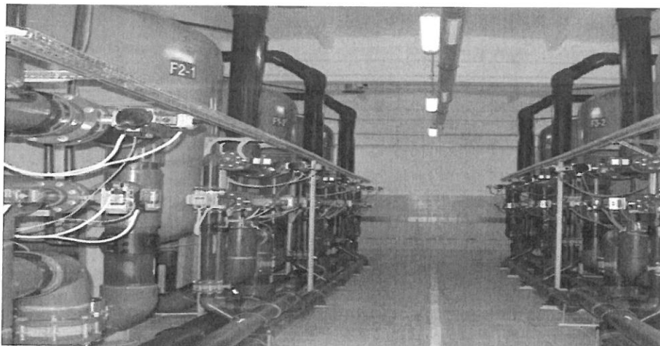
Rysunek 1 Stacja uzdatniania wody w Nisku
