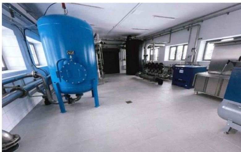
Stacja uzdatniania wody w Hucie Krzeszowskiej
